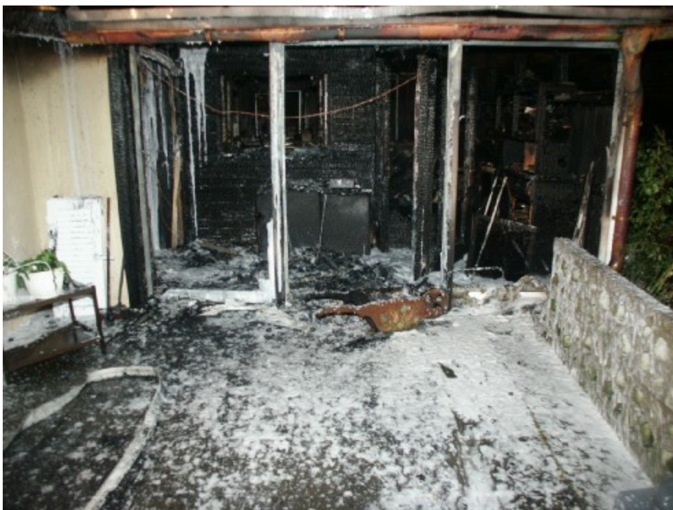
Blick vom Garten in den vom Brand stark betroffenen Teil
